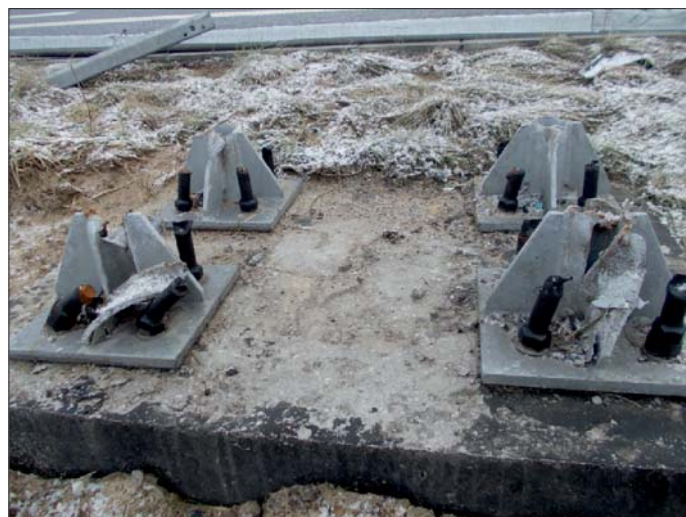
Fot. 12. Ścięty słup kratowy (fot. Krzysztof Konecki)
